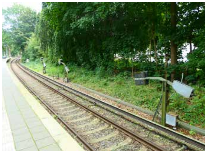
Bf. Sülldorf, 2021, alte Stellwerktechnik
